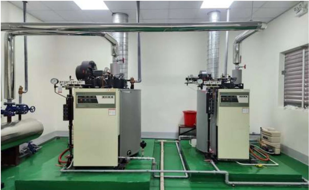
Hình 3.8. Hình ảnh nồi hơi đốt dầu của nhà máy
